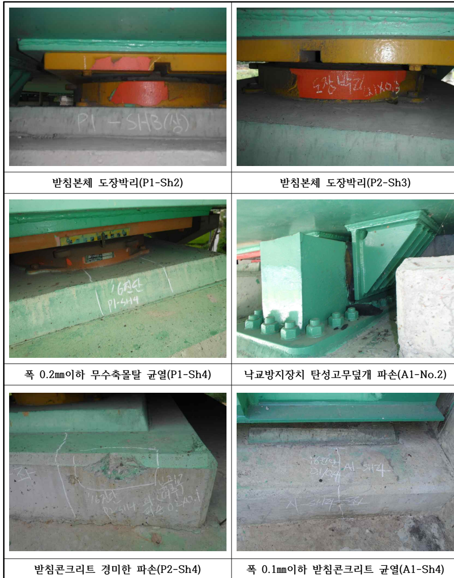
【사진 3.30】 교량받침 손상현황(여주)
