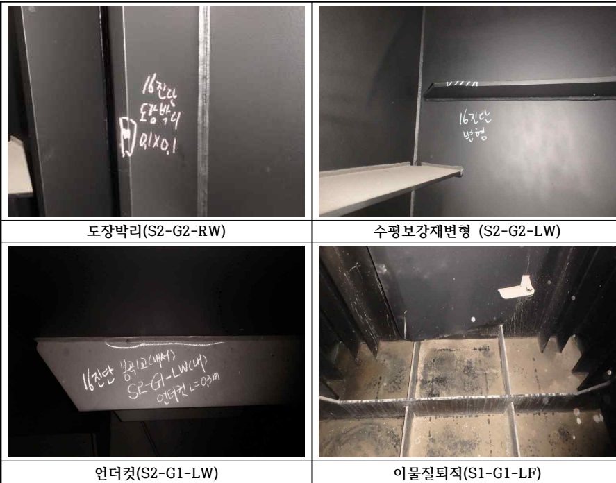
【사진 3.5】 강박스 거더 내부 손상현황(내서)
