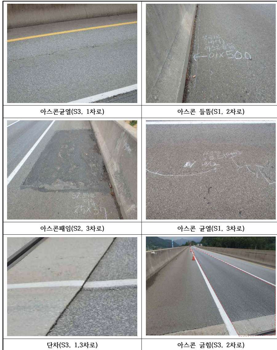
【사진 3.17】 교면포장 손상현황(내서)
