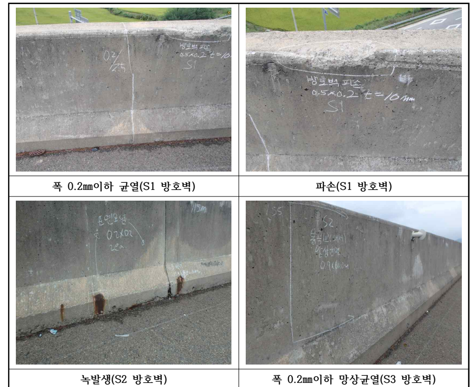
【사진 3.20】 난간 및 연석 손상현황(내서)
