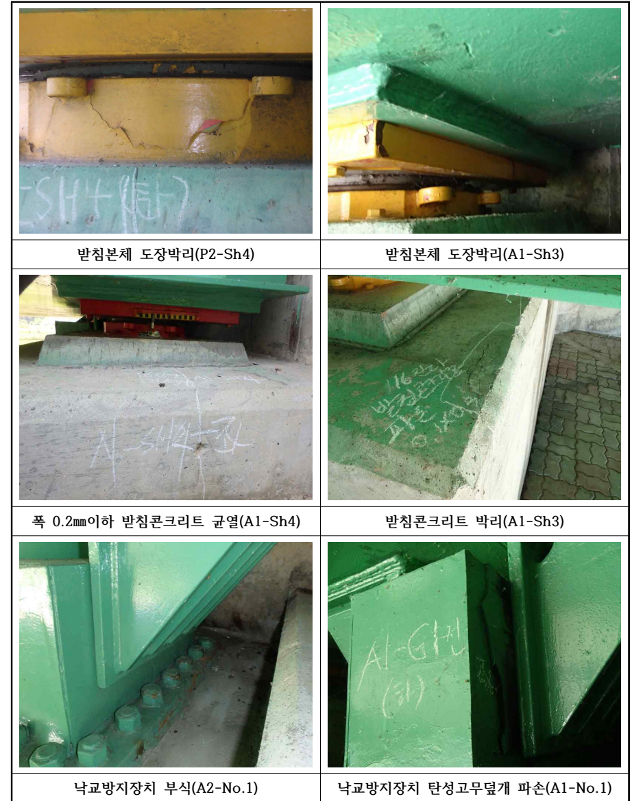
【사진 3.11】교량받침 손상현황(내서)
