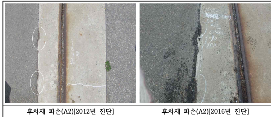
【사진 3.15】신축이음장치 후타재 파손 진전 현황
