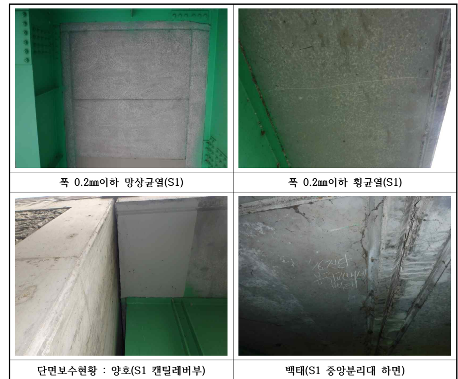
【사진 3.3】바닥판 손상현황(내서)
