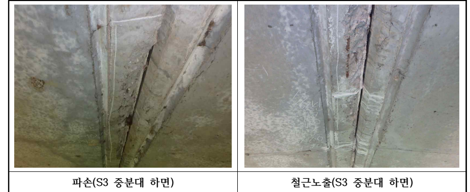
【사진 3.22】바닥판 손상현황(여주) (계속)
