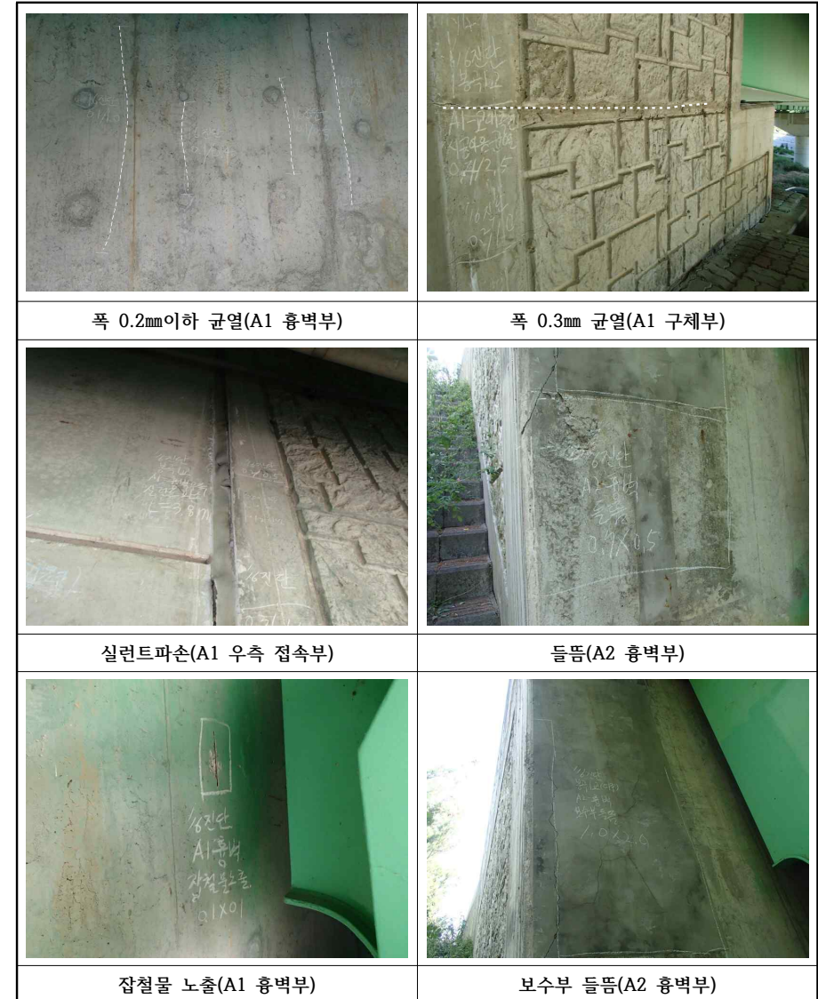
【사진 3.28】 교대 및 교각 손상현황(여주)
