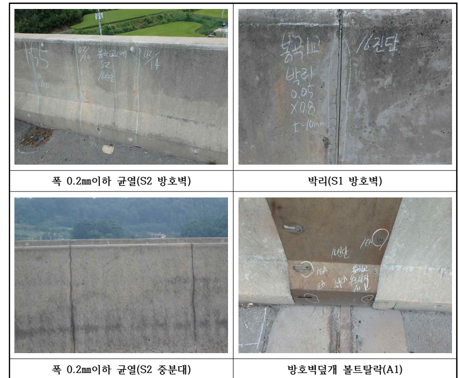
【사진 3.38】 난간 및 연석 손상현황(여주)
