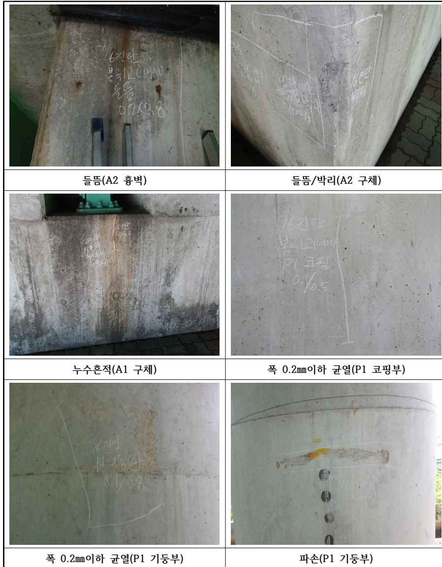
【사진 3.9】 교대 및 교각 손상현황(내서)(계속)
