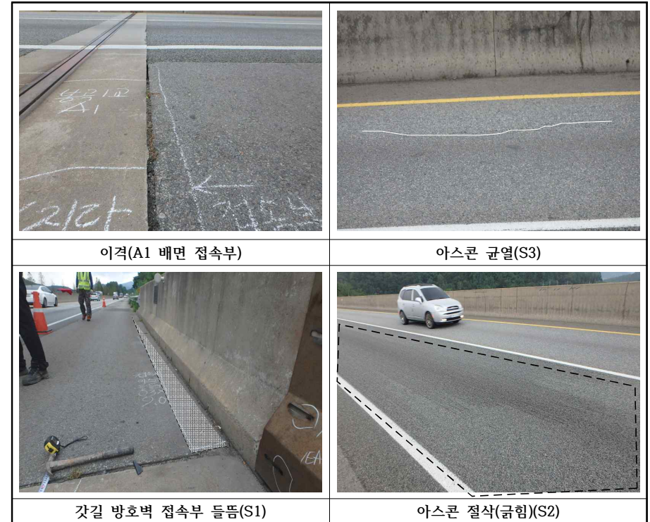
【사진 3.35】 교량포장 손상현황(여주)
