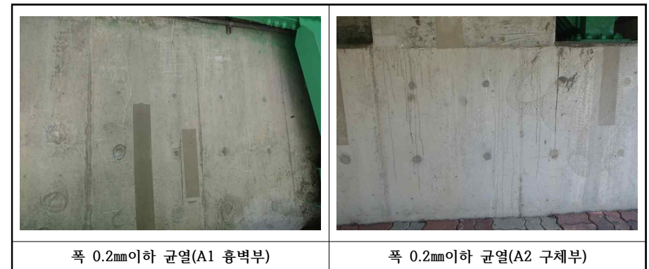
【사진 3.9】 교대 및 교각 손상현황(내서)
