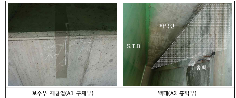
【사진 3.9】 교대 및 교각 손상현황(내서)(계속)
