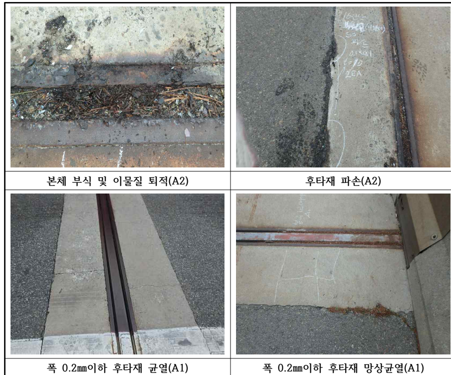
【사진 3.13】신축이음장치 손상현황(내서)
