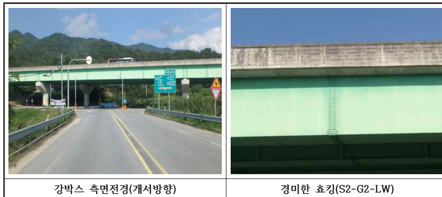
【사진 3.6】 강박스 거더 외부 손상현황
