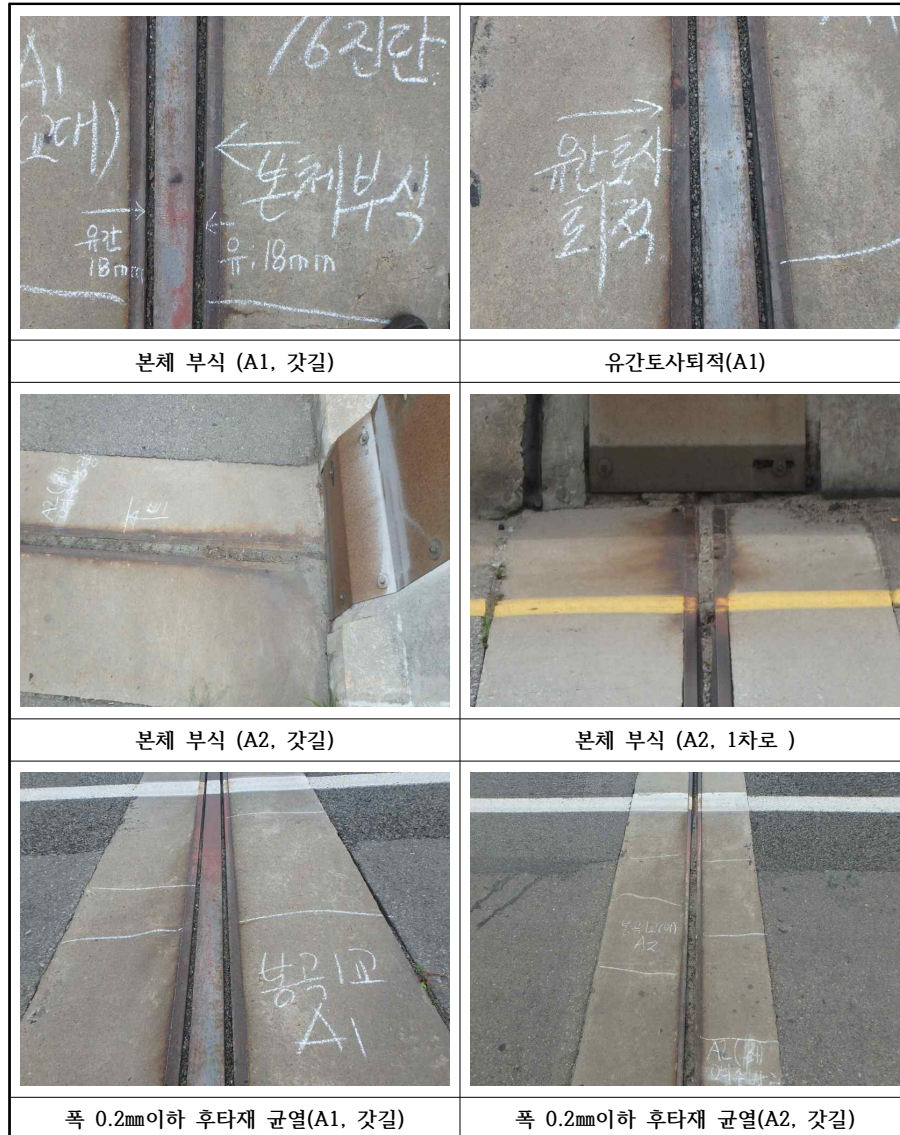
【사진 3.32】 신축이음장치 손상현황(여주)
