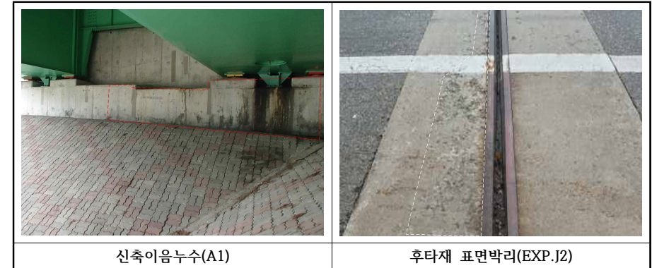
【사진 3.13】신축이음장치 손상현황(내서) (계속)
